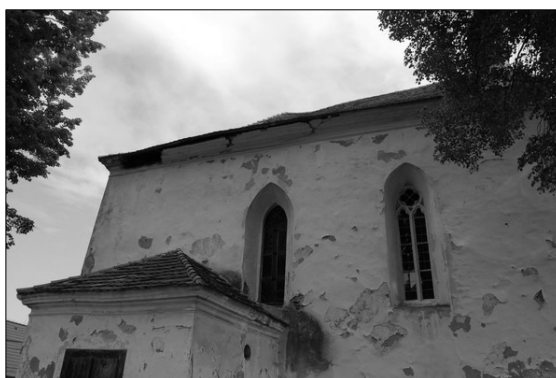
fot. Poškozená fasáda a střecha třebnického kostela
